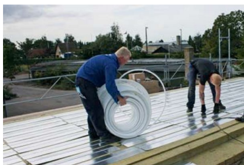
Figur 33 - Slangerne til varmepumpe i tagkonstruktion [1]
