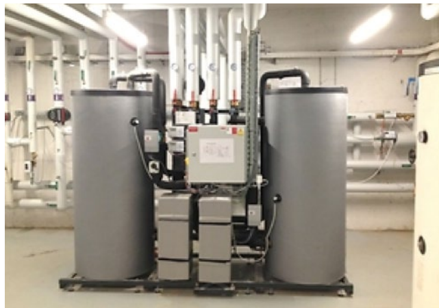
Figur 50 - Danfoss varmegenvindingsunit (HRU) til varmegenvinding fra et køleanlæg (Kilde: https://www.energy-supply.dk/announcement/view/103768/overskudsvarme_fra_koleanlaeg_bruges_som_fjernvarme )
