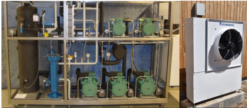
Figur 49 - Eksempel af et CO 2 køleanlæg. Indendørs (til venstre) og udeenhed (luftkølet kondensator) (til højre) Kilde: JF køleteknik A/S
