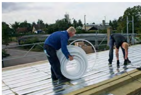
Figur 33 - Slangerne til varmepumpe i tagkonstruktion [1]
